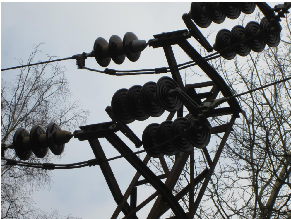
Keramické izolátory na venkovním vedení
